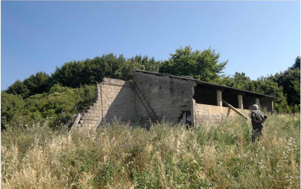
Figura 2 - Resti del fabbricato. In evidenza la parte non demolita dalla collisione dell'aereo non oggetto di intervento, che ricade al di fuori della proprietà Laore.
