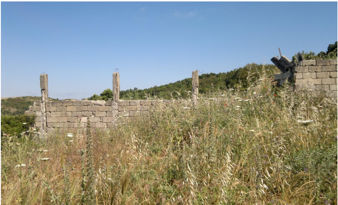
Figura 3- Resti delle murature in blocchi di calcestruzzo e pilastri.
