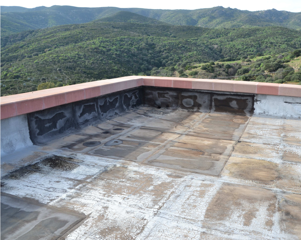
Particolare di un punto di scarico delle acque meteoriche
